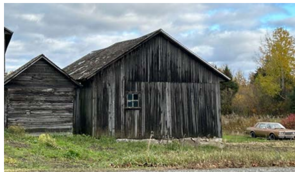
Bardeau de bois sur le toit. 107, route 293, Saint-Jean-de-Dieu
